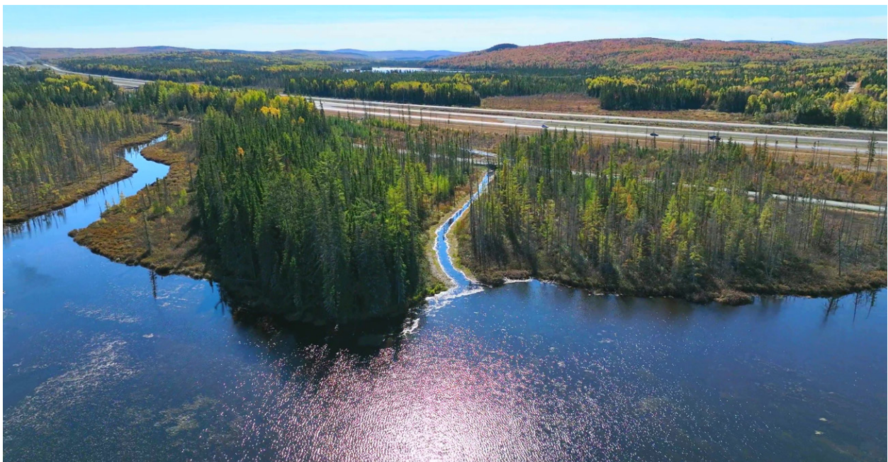
Le tracé de l'A85 et la route 185 ont été déplacés pour préserver le milieu humide et la piste cyclable du Parc linéaire interprovincial du Petit-Témis.
